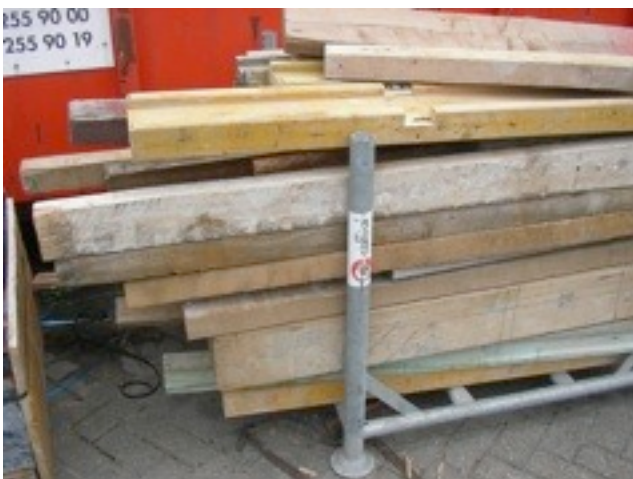
Les poutres en bois utilisées pour la menuiserie de chantier sont souvent jetées comme déchets à la fin du chantier.
