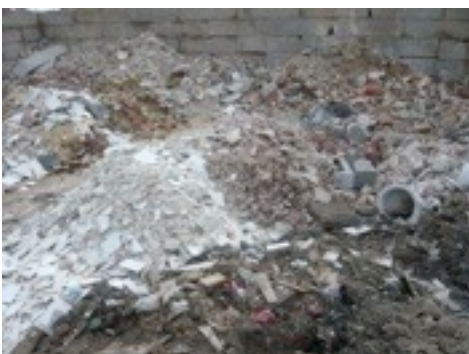
Débris de maçonnerie et de faïence.
